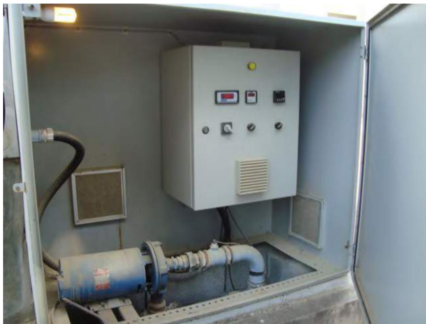
Foto 36 - Booster Rua Piauí
