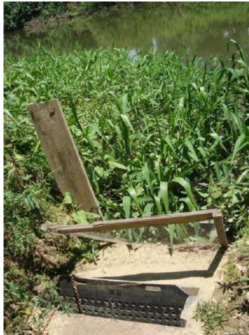
Foto 2 - Grade de Captação
