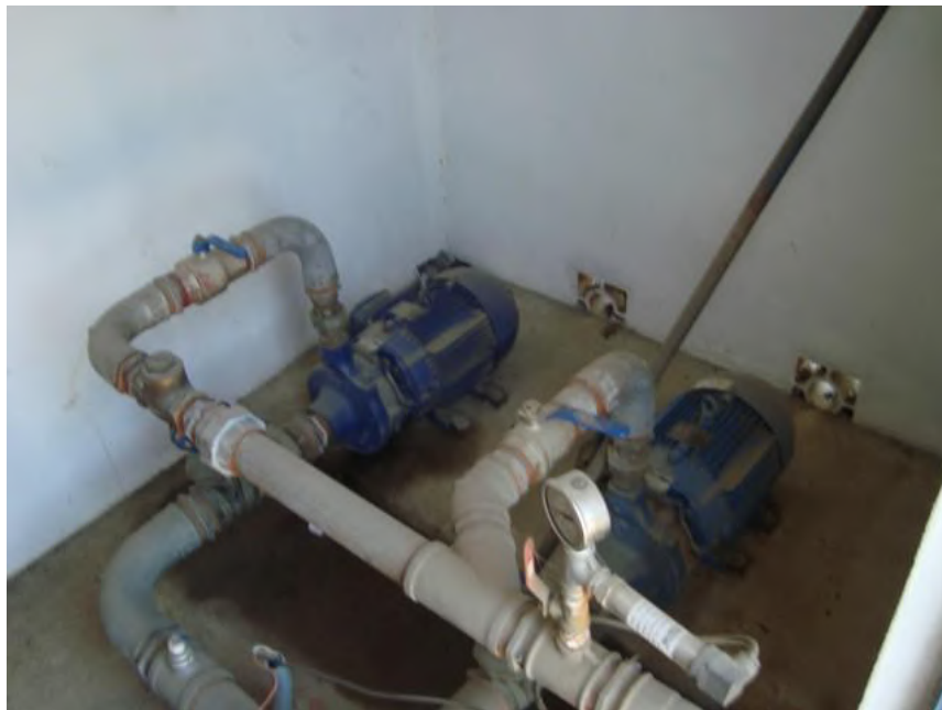
Foto 26 - Booster Quintino Bocaiúva (motobombas)
