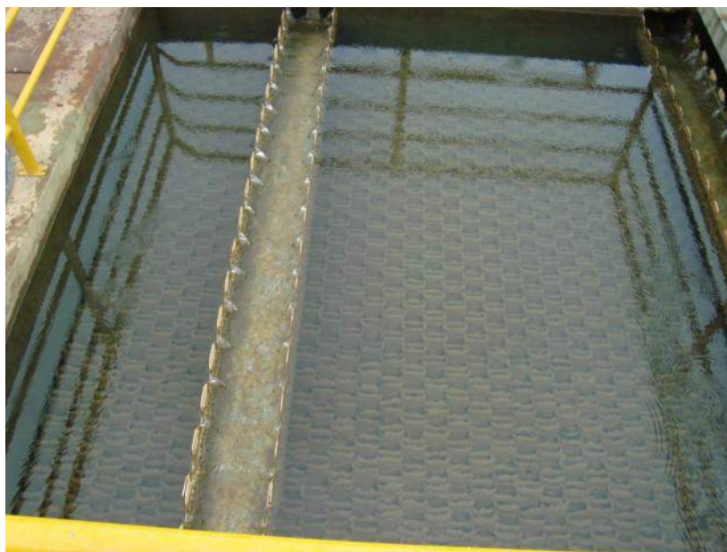
Foto 9 - Etapa de floculação/decantação
