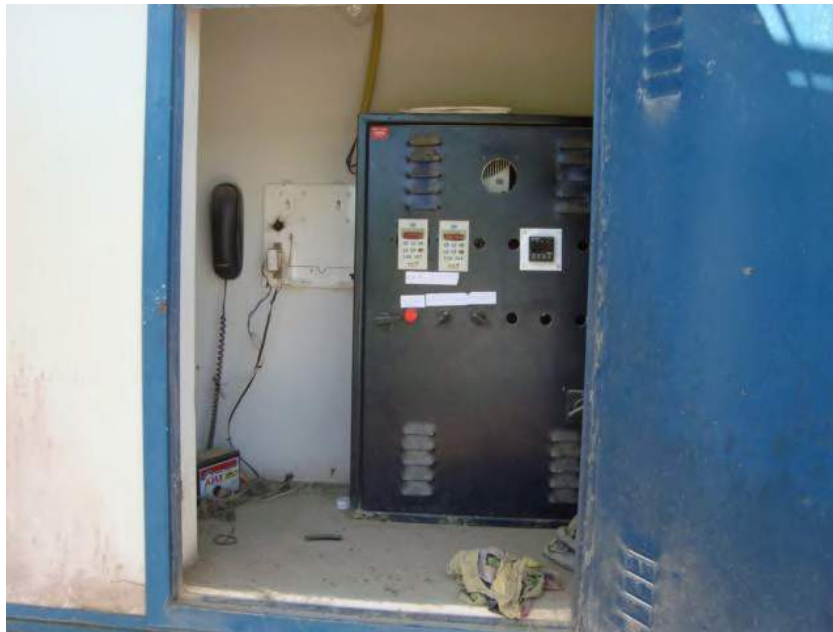
Foto 24 - Booster Rua Seara
