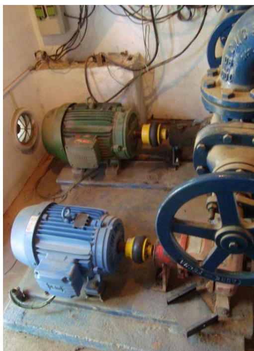
Foto 15 - EEAT R. Blumenau (imotobombas)
