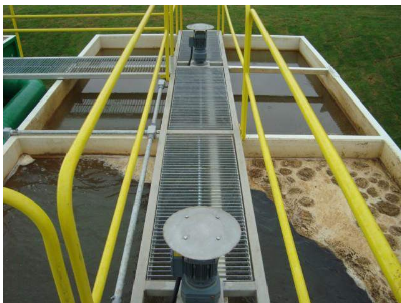
Foto 7 – Etapa de coagulação (ETA compacta)
