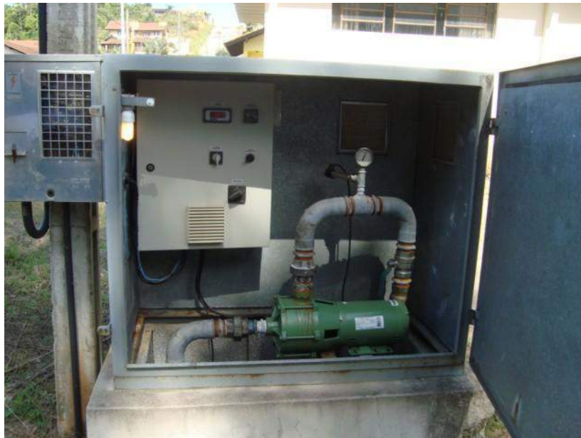
Foto 34 - Booster Rua São Carlos
