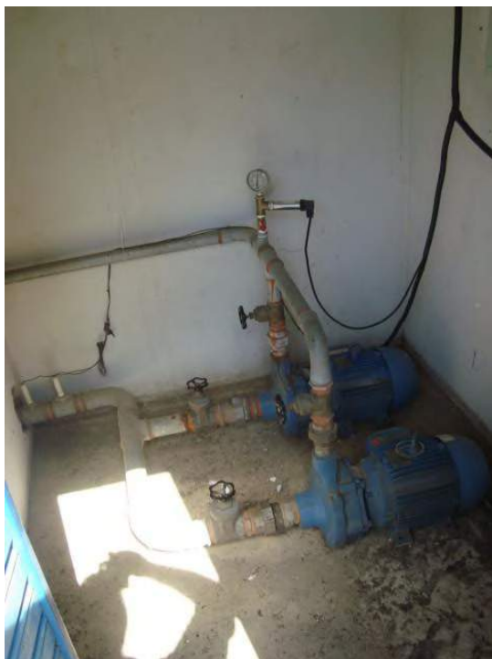
Foto 31 - Booster Guabiruba (motobombas)
