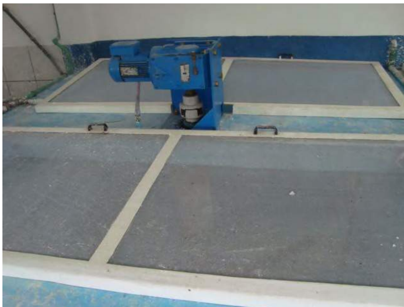
Foto 12 - Tinas de dosagem de produtos químicos
