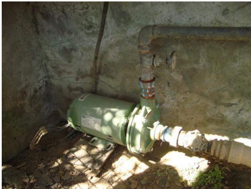
Foto 28 - Booster R. Alfredo Hansen (motobomba)
