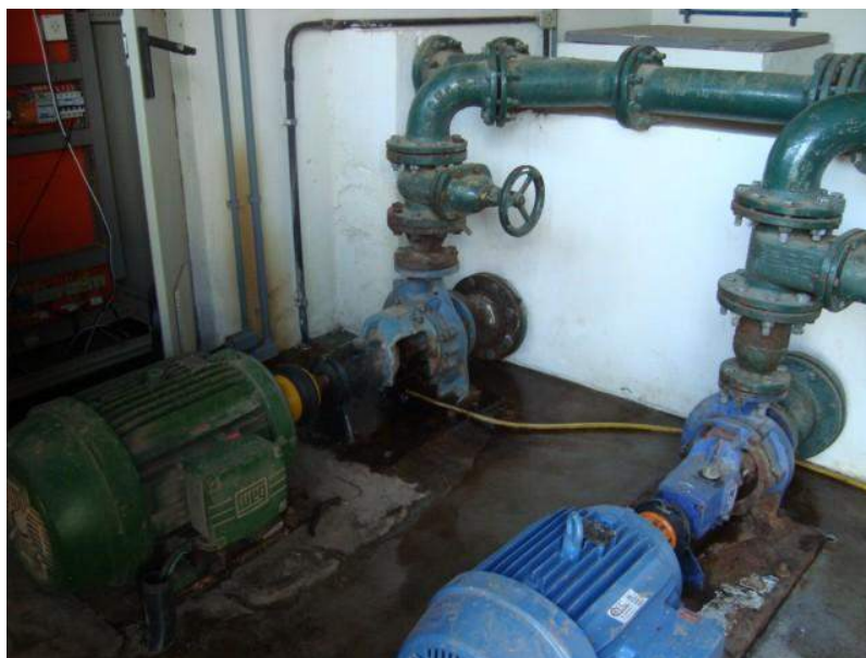
Foto 19 - EEAT Rua Groelândia (interno)
