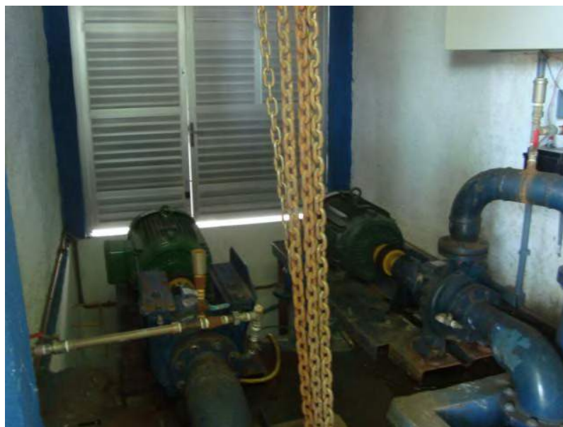
Foto 17 - EEAT Quintino Bocaiúva (motobombas)
