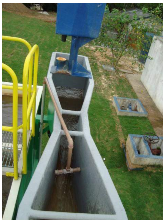
Foto 5 - Entrada da água bruta e adição de sulfato de alumínio (ETA compacta - Calha Parshall)
