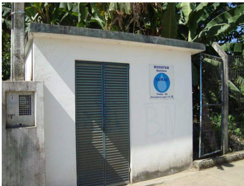
Foto 25 - Booster Quintino Bocaiúva
