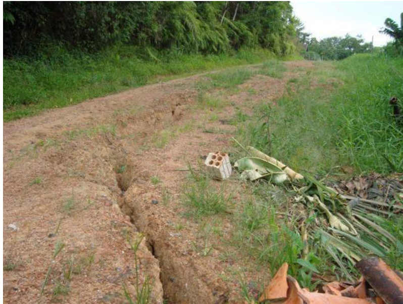
Foto 67 - Indício (início) de deslizamento de terra (R. Palotina) – já recuperada
