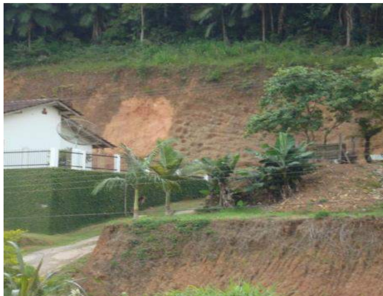
Foto 68 - Ponto com probabilidade de risco de deslizamento (R. Belo Horizonte)
