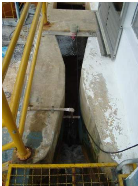
Foto 4 - Entrada da água bruta e adição de Sulfato de alumínio (ETA convencional - Calha Parshall)
