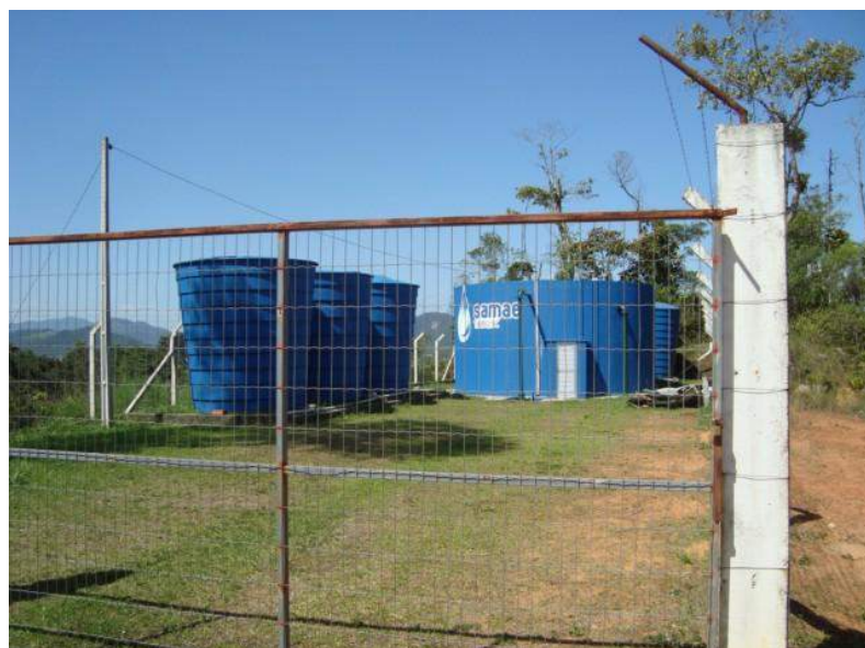
Foto 39 – Conj. de Reservatórios R. Tamoio
