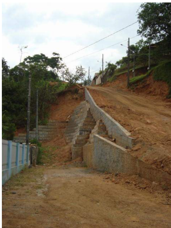
Foto 66 - Ponto que teve problema com deslizamento (R. Diamantina)
