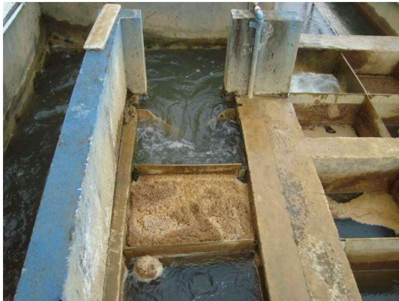
Foto 8 – Etapa de coagulação (ETA convencional)
