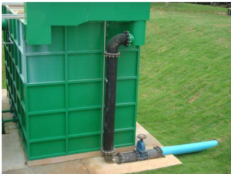
Foto 6 - Tubulação de entrada de água bruta
